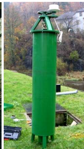
Kotlová verze turbíny: ČOV Stříbro
